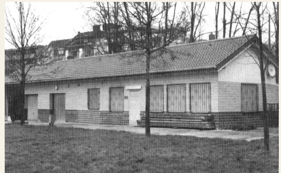
Schmuck sieht sie aus. Die „Hockeyhütte“ mit ihrem neuen Dach. Das alte Flachdach war durch den Sturm beschädigt und mußte erneuert werden.
